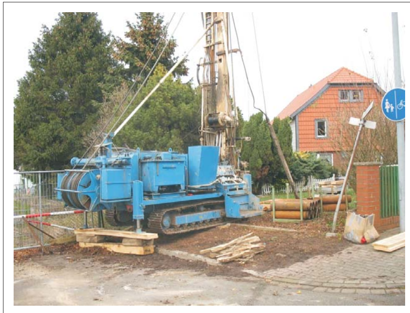
Bild 3: Durchführung der Bohrung mit durchgehender Gewinnung gekernter Proben zur Erkundung der Karstausbildung im Osten, 02.12.2009
