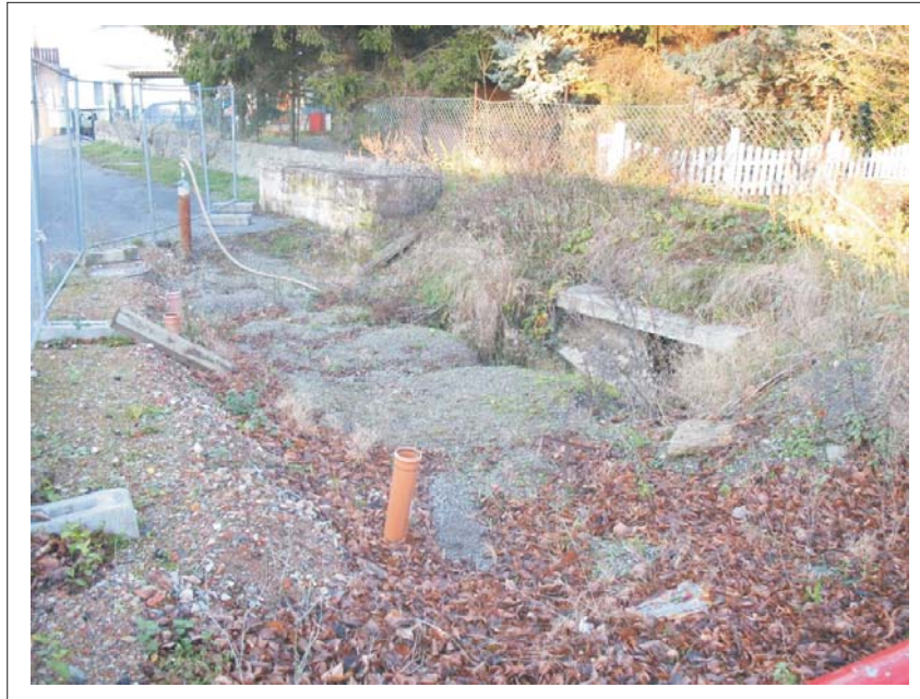
Bild 1: Bodenabsenkung am 02.12.2009. Ansatzstellen ehemaliger Bohrungen aus Dezember 2009 sind durch PVC-Rohre kenntlich gemacht, 02.12.2009
